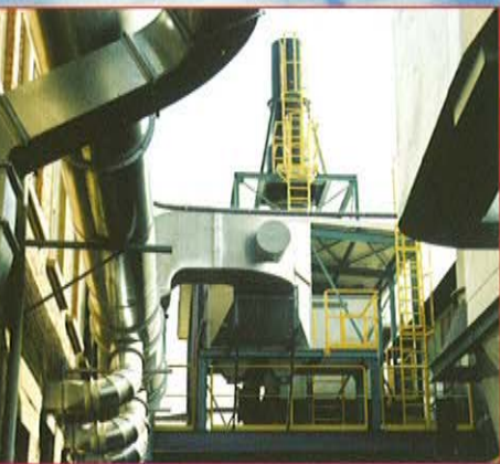
Высокопроизводительный абсорбер ма 36.000 м³/h. Absorber wysokiej wydajności 36.000 m³/h.
